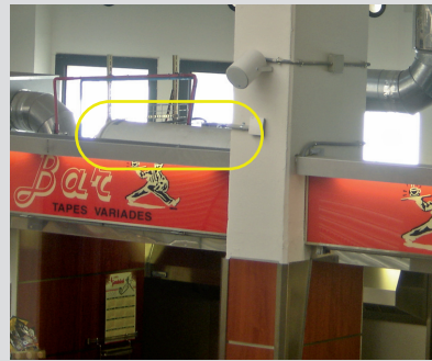
A la dreta: Dipòsit col·locat horitzontalment.
